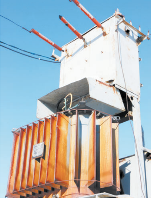
Рис 1.2. Трансформатор на подстанции понижает напряжение от высоковольтной линии для передачи в бытовую сеть
